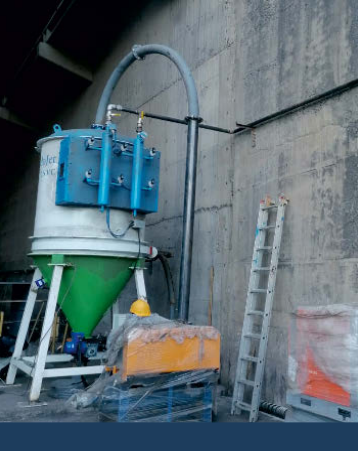
Vc126 Yüksek Vakum Ünitesi
